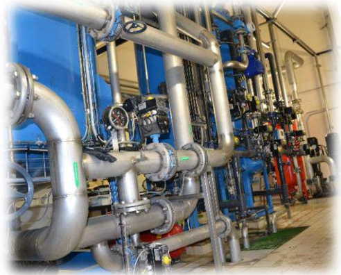
Unité de traitement des nitrates et des pesticides de Villenauxe-la-Grande.
